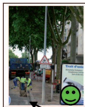
Passages de réseaux en bord de voirie
