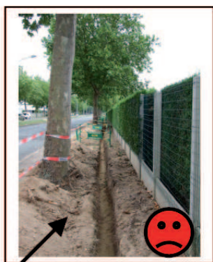
Passages de réseaux au pied de platanes existants (dégâts sur les arbres + difficultés lorsqu'il faudra remplacer ces arbres).
